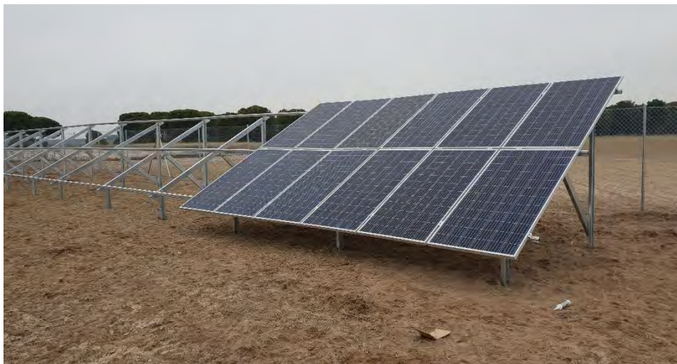
Parque Fotovoltaico sobre terreno – Estructura Fija
