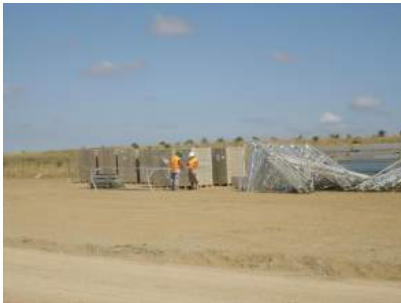
Imagen 8. Fotografía de instalaciones provisionales
