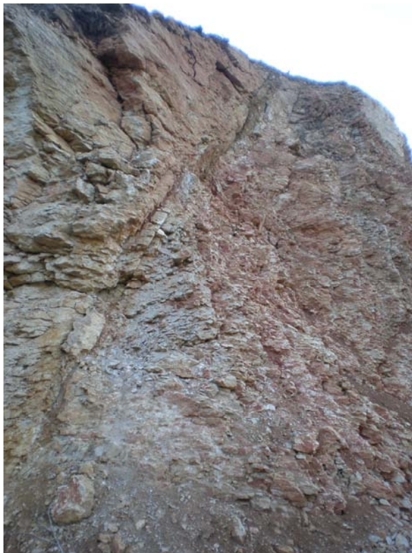
Fotografía 10.- Vista de parte del material que forma el talud en la estación T15, en donde se observa una fractura desarrollada sobre el material calizo.
