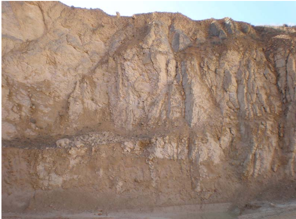
Fotografía 15.- Vista general del talud en donde se define la estación T20. Se observa la elevada fracturación del material. En la zona inferior se observa el talud cubierto de polvo que imposibilitó la realización de medidas estructurales.
