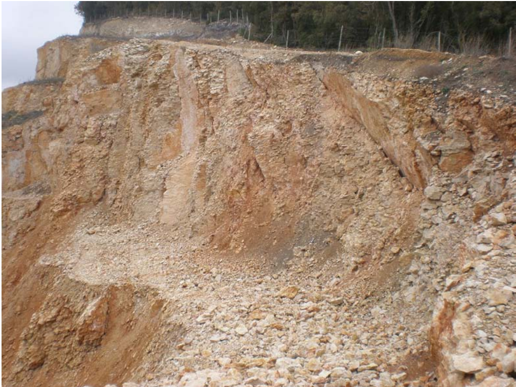
Fotografía 6.- Imagen tomada en el talud en el que se levantó la estación T10, en la que se puede observar una fractura buzando hacia el interior, dejando material rocoso en voladizo.
