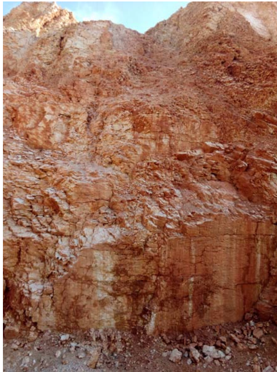
Fotografía 19.- Vista general del talud en donde se define la estación T24. Se observa una intensa fracturación en el material que da al talud un aspecto caótico. En la base, se observa un gran plano de fractura buzando 80° hacia el interior del talud, que podría originar caídas por vuelco.
