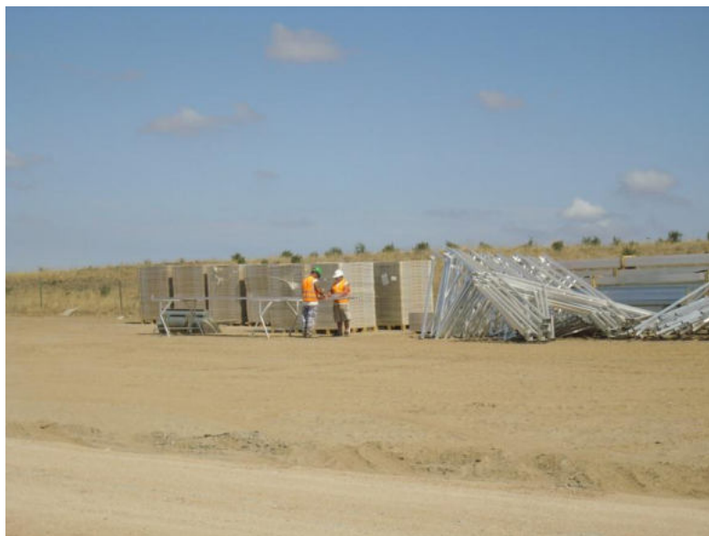
Imagen 7. Fotografía de instalaciones provisionales
