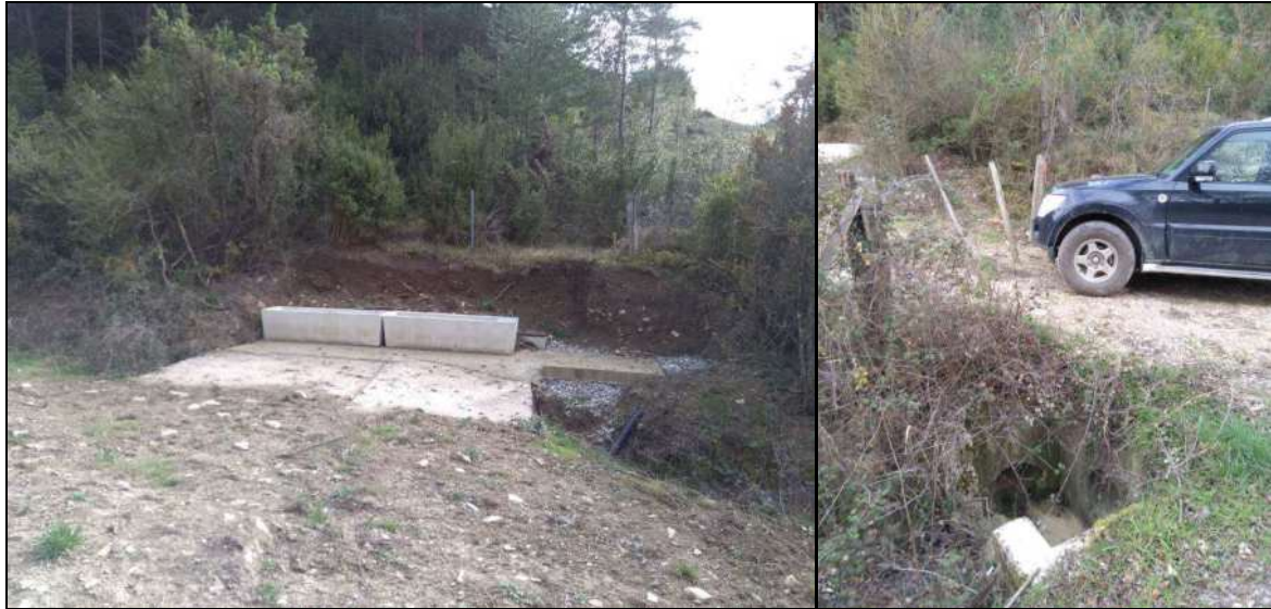
Infraestructuras 214. Abrevadero anexo al campo de cultivo (en zona comunal pero acceso adecuado desde finca) y tubo de entrada a finca.
