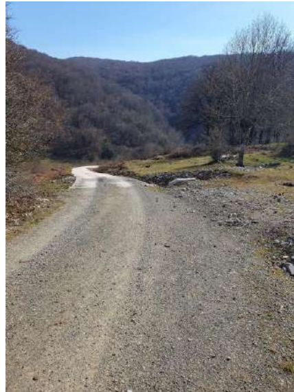
Final afección tramo N° 2 al monte N° 550.
