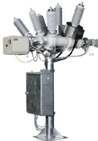
Figura 1: Ejemplo de Equipo compacto en posición de línea.
