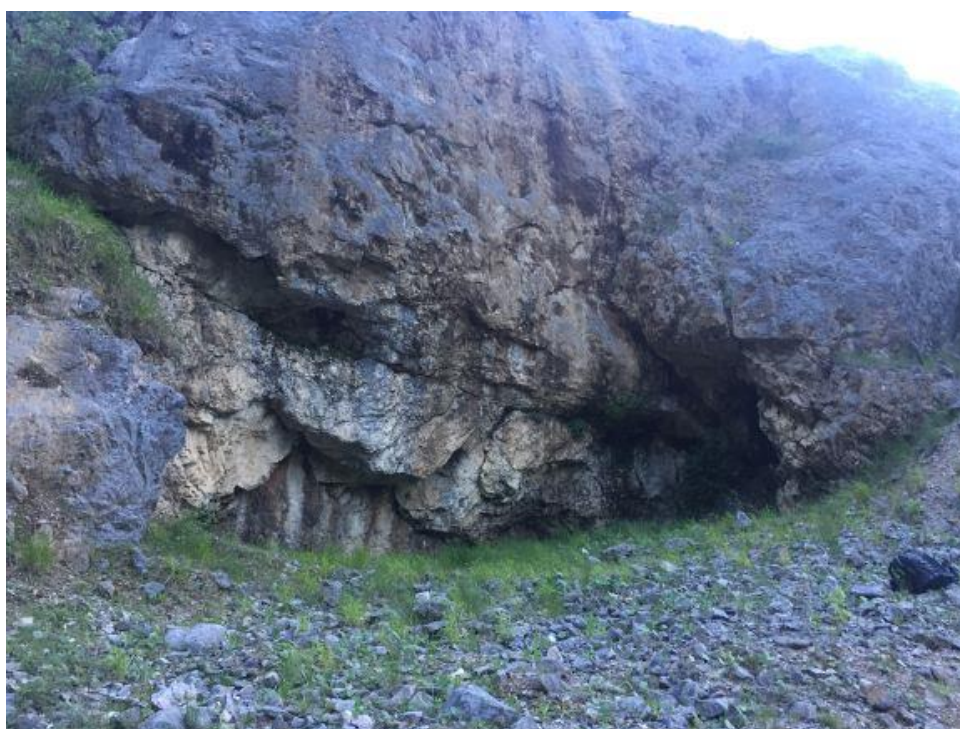
Pared rocosa con grietas y pequeños huecos, que fue inspeccionada al anochecer.
