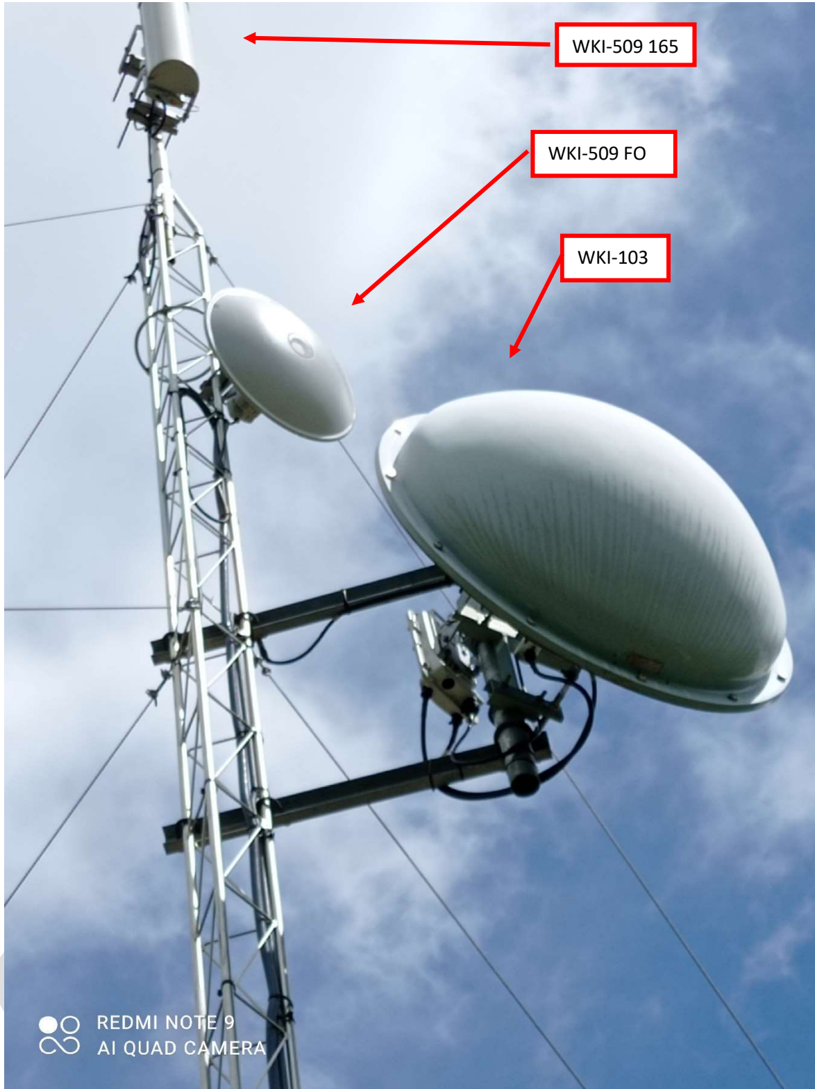
Figura 6 - Ubicación de antenas en torre
