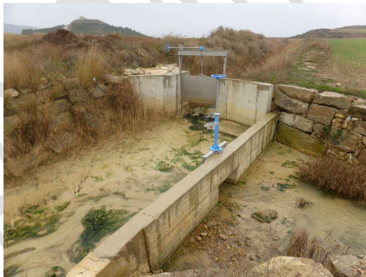
Imagen 1. Nuevo sistema de regulación de entrada de agua a la Laguna de Pitillas desde Barranco del Pozo del Pastor a través de la acequia Sabasán. La acequia a la derecha es el retorno al Barranco del Pozo del Pastor.
