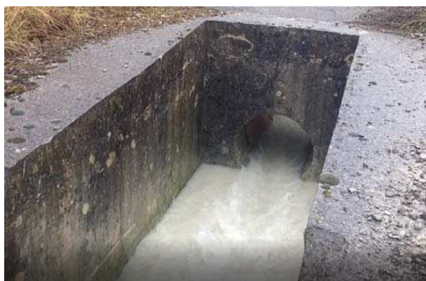
Salida Decantador-2 y entrada a Decantador-1
