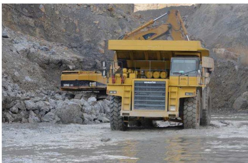
Figura 2 Medidas no estructurales a adoptar para evitar la contaminación de las aguas de superficie. Evita zonas de embalsamiento de aguas de forma descontrolada y no circular camiones sobre las mismas.
