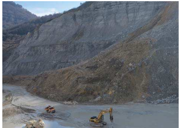
Tierras vertidas desde la coronación del frente de cantera hasta la plaza de la misma
