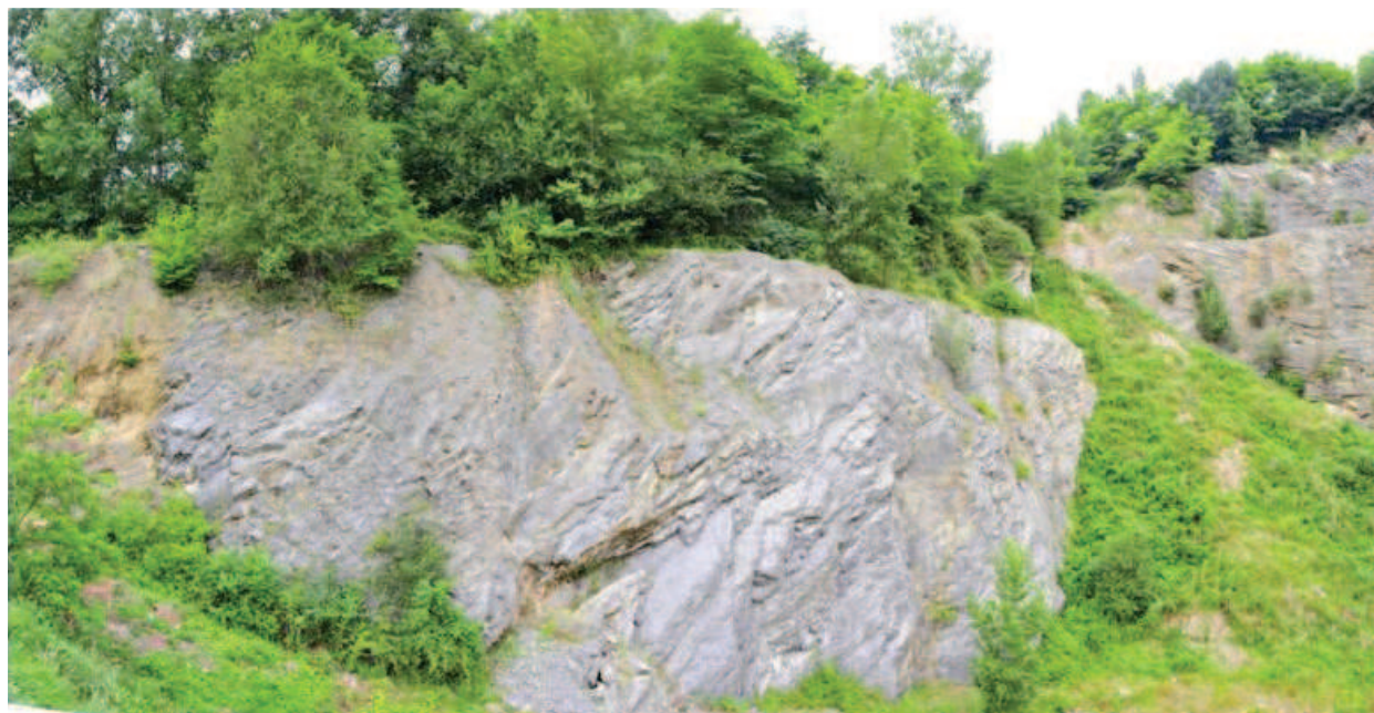
Imagen 16: Fotografía del talud Oeste donde se observa que a excepción de los tramos verticalizados del talud, el resto esta colonizado por especies vegetales
