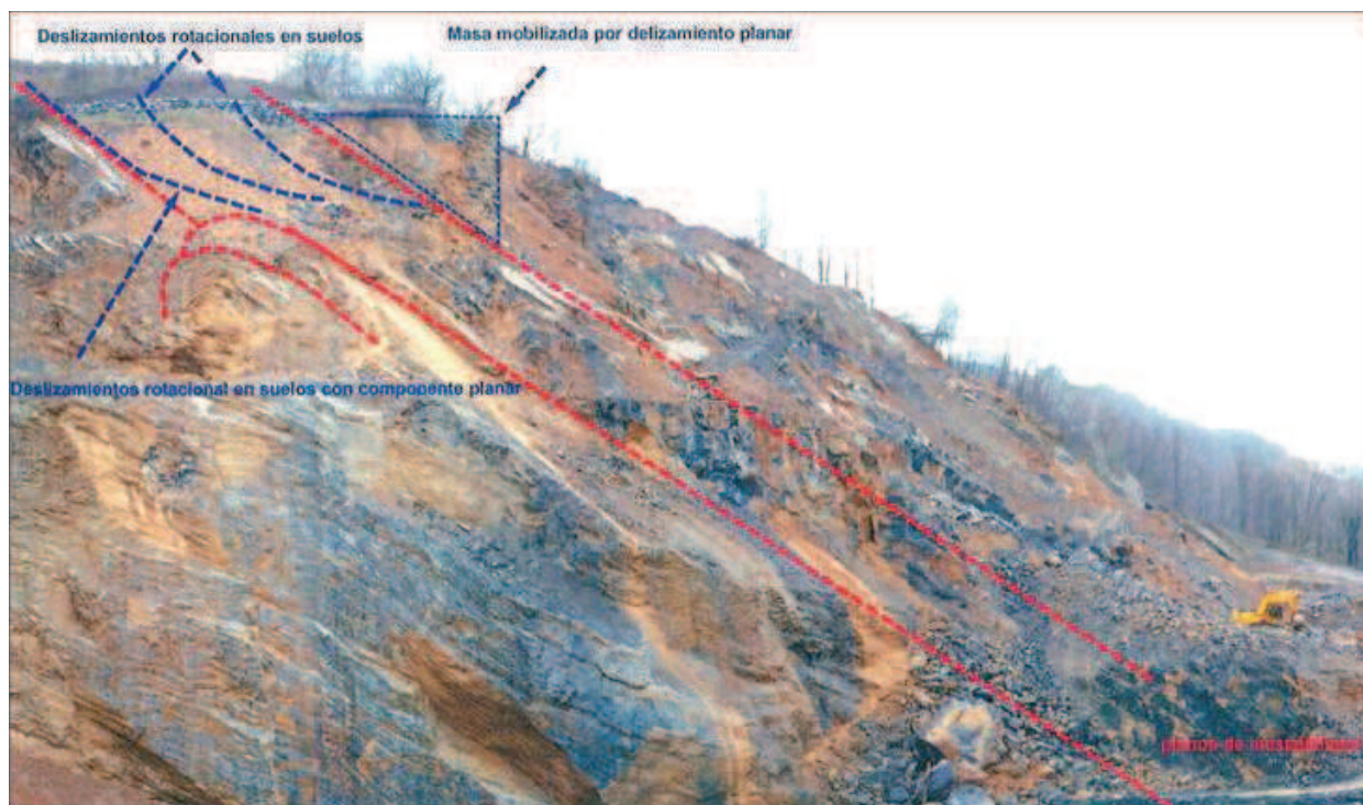
Imagen 9: Imagen extraída del Estudio geológico donde se indican los fenómenos asociados al deslizamiento de 2.006 en el talud norte
