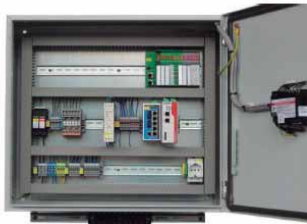
Ilustración 3. Armario del Controlador de Planta (PPC).
