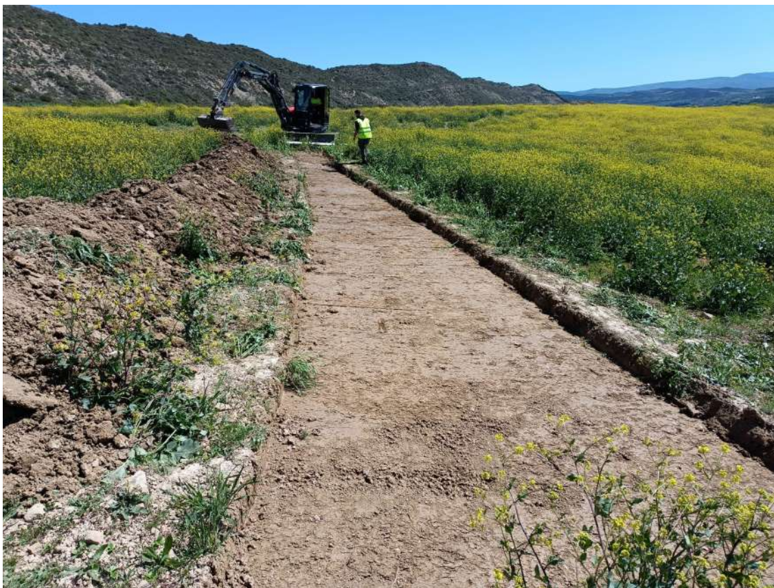
Decapado en la banda de protección de Uñesa I
